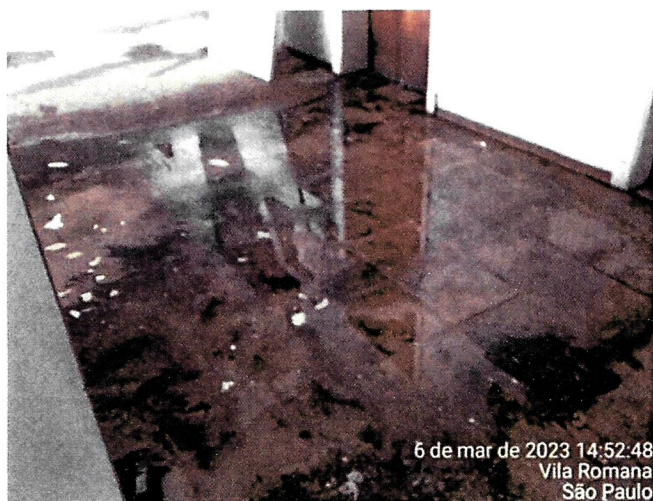
Foto 5 – Poças d'água existentes no 6º pavimento
