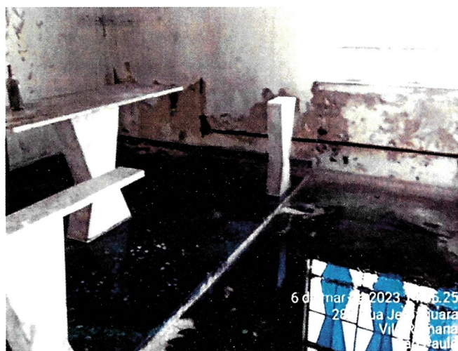
Foto 6 – Poças d'água existentes no 6º pavimento
